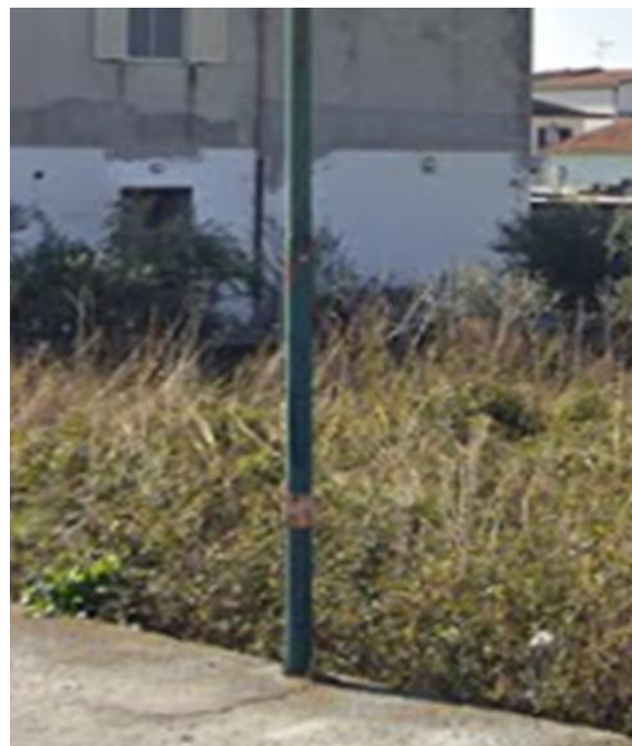
Sostegno con segni di corrosione
