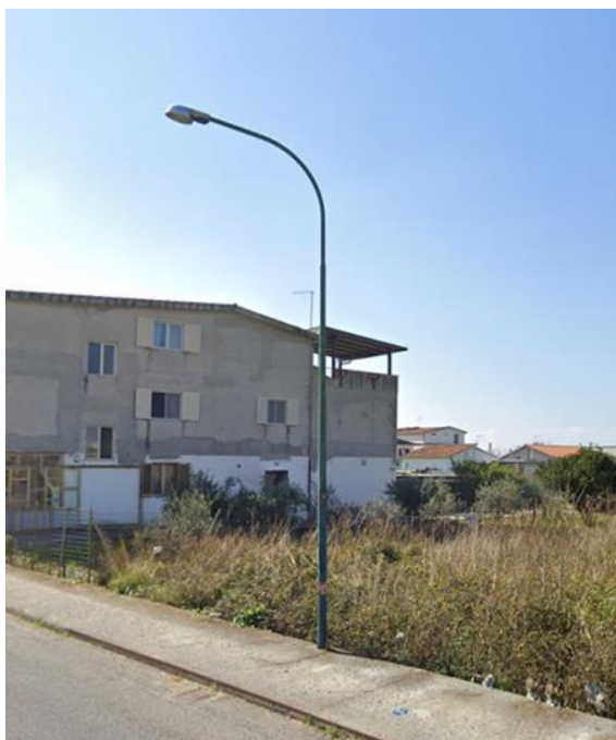
Armatura priva di vetro
